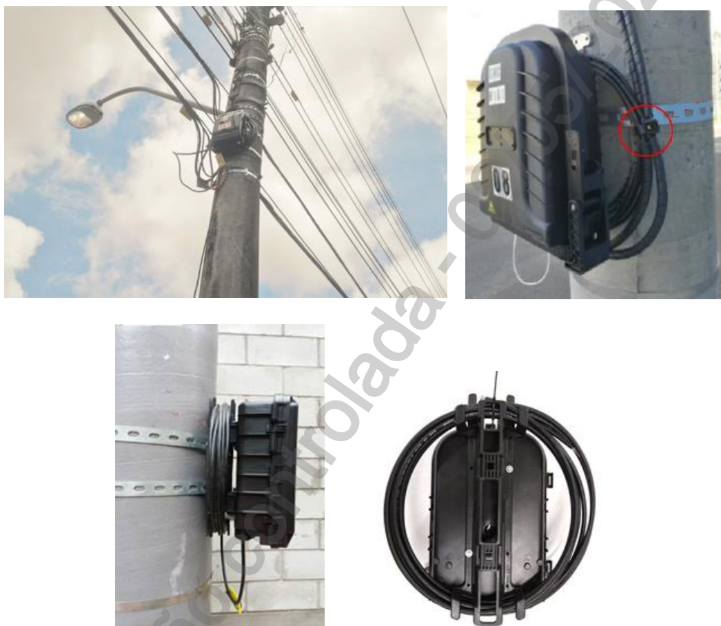
Figura 5 – Exemplos de Caixa CTO/NAP com Cabo de Descida Acomodado Atrás da Caixa
